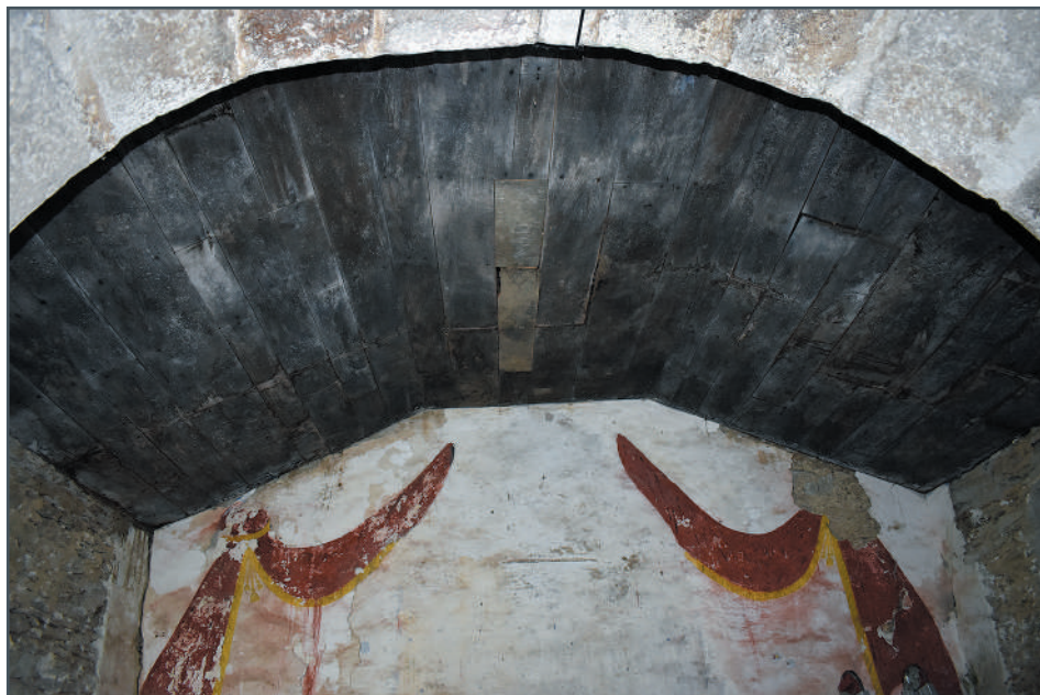
Teito da cabeceira antes da restauración
