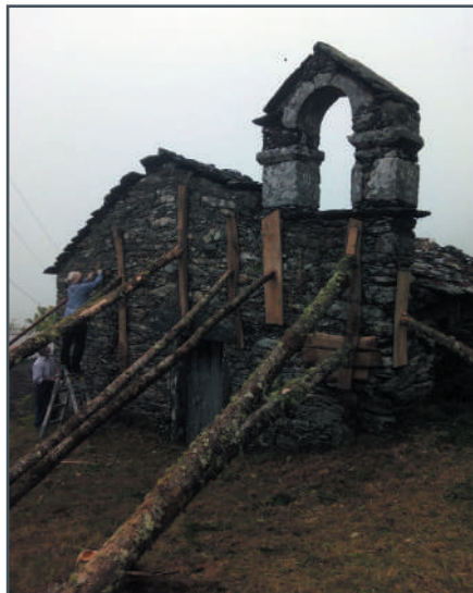
A fachada apuntalada por perigo de derrubamento
