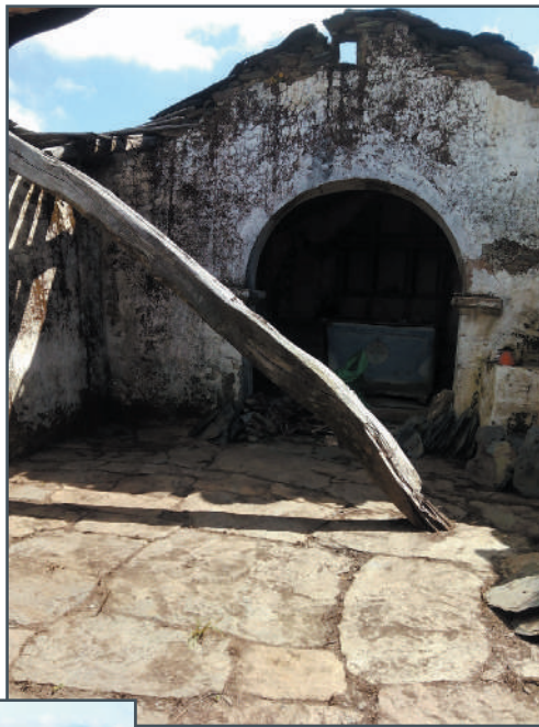
Interior depois do colapso da cuberta
